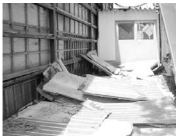
外壁の崩れた寒風沢島の体育館避難所。内壁には穴が空き外気が入ってくる
